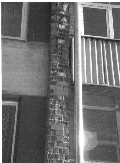
2.attēls. Stipri bojāti ēkas māla ķieģeļi.
