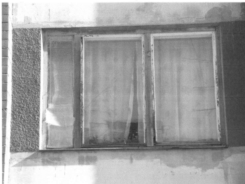
3.attēls. Ēkas koka logi sliktā tehniskā stāvoklī, ietiecama šo elementu nomaiņa.
