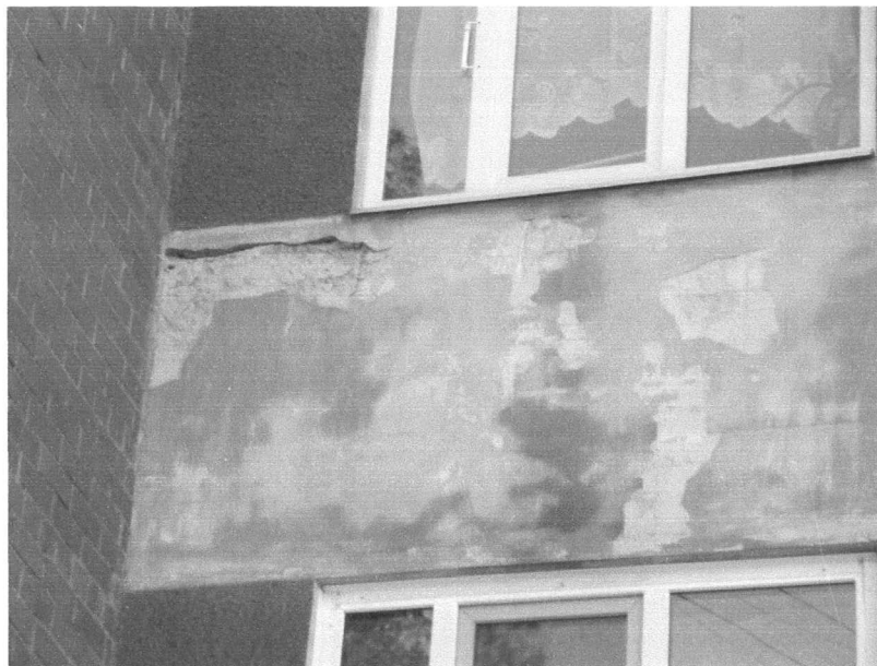
1.attēls. Ēkai mitruma un nokrišņu rezultātā bojātas ārsienu norobežojošās konstrukcijas. Daļa ēkas koka logu nomainīta pret PVC tipa pakešu logiem.
